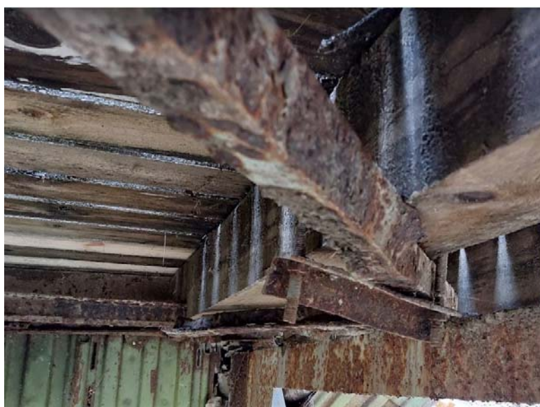
8 pav. Ryšių elementai stipriai paveikti korozijos
