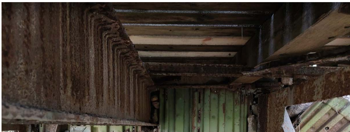
7 pav. Paklotą laikanti sija stipriai paveikta korozijos
